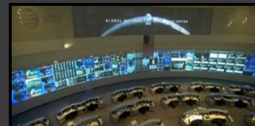
AT&T, New Jersey (USA)
